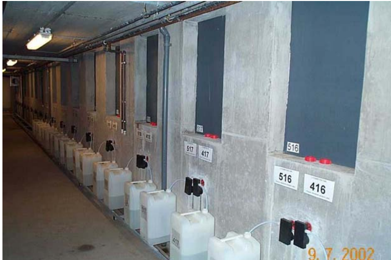
Figur 4. Underjordisk inspektionsgang med dunke til opsamling af drænvand.
