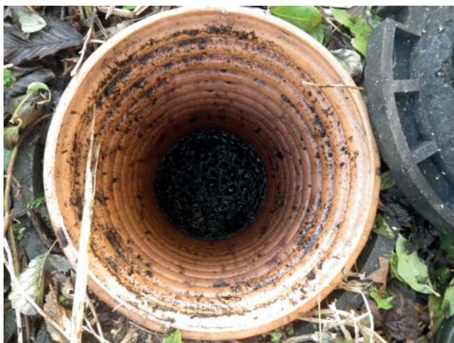
Figur 2: Sandfangsbrønde skal helst føres op til overfladen, så de er lette at tilse i vintermånederne. Løber vandet som forventeligt? Måske er sandfanget i bunden af brønden fyldt op med bundfaldet silt og finsand, så fraløbet er blokeret. Det er en stor fordel at bruge lette dæksler, som er nemme at løfte. Dæksler kan fås med kunstgræs, hvis de skal kamoufleres. Foto: Asbjørn Nyholt.
